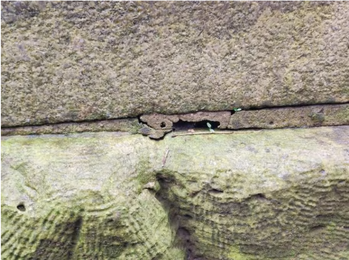
Ubytki spoiny na styku piaskowcowej podstawy z granitowym cokołem.
