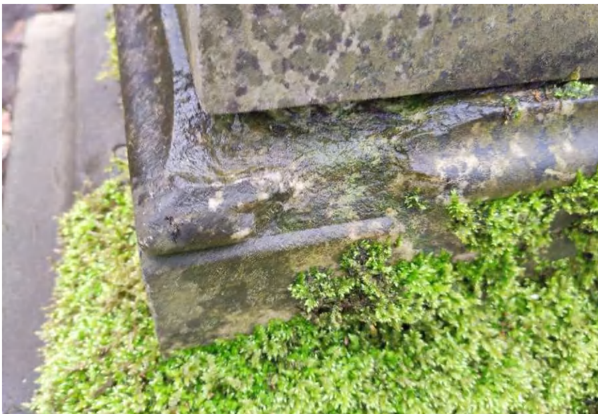
Ubytek w profilowanej krawędzi cokołu, zbliżenie na nawarstwienia chemiczne oraz punktowo porastającą powierzchnię kamienia mchy.
