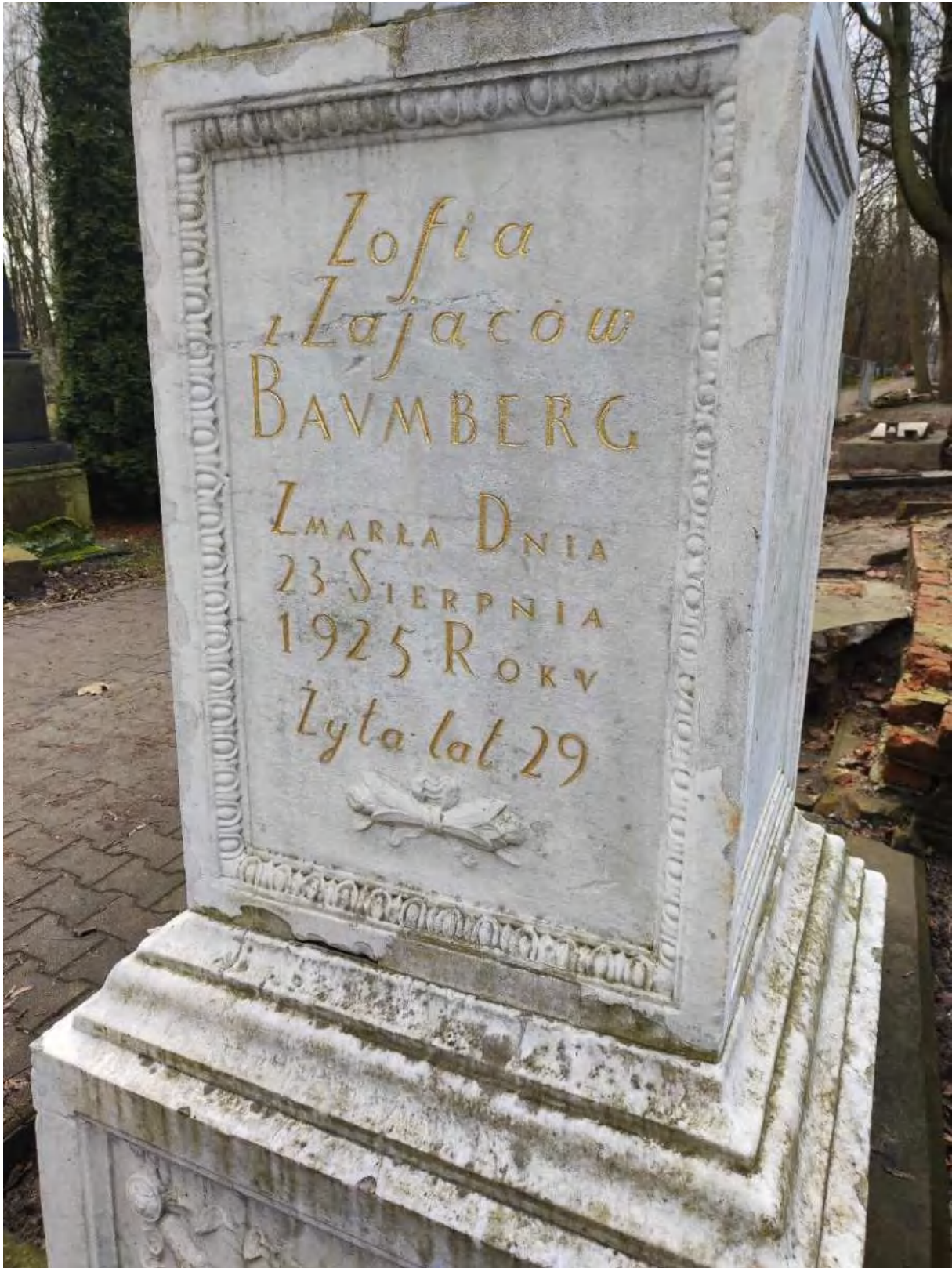
Powierzchnowe nawarstwienia biologiczne i brud, przebarwione spoiny i kity mineralne.
