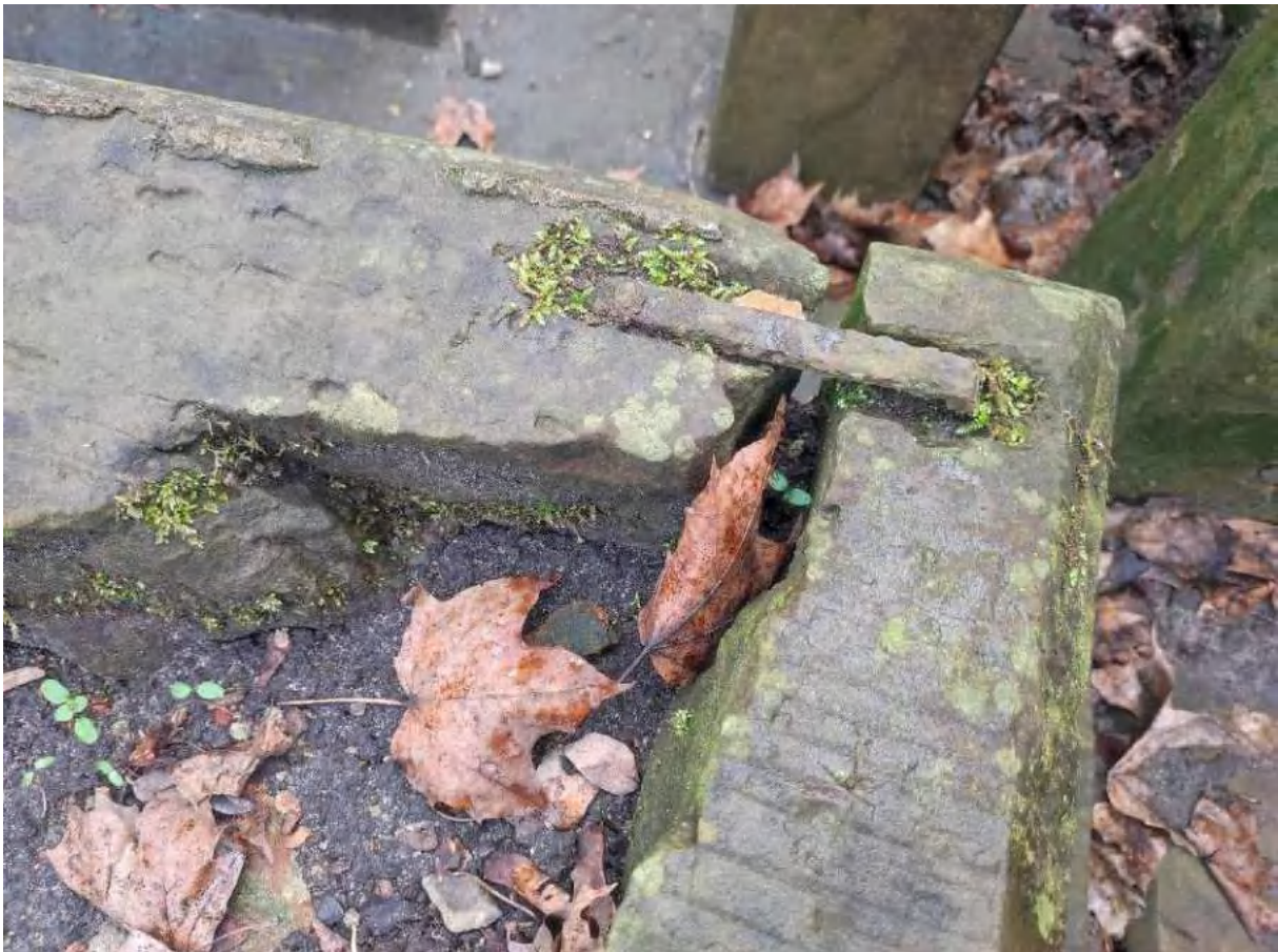
Stan zachowania - detal.
