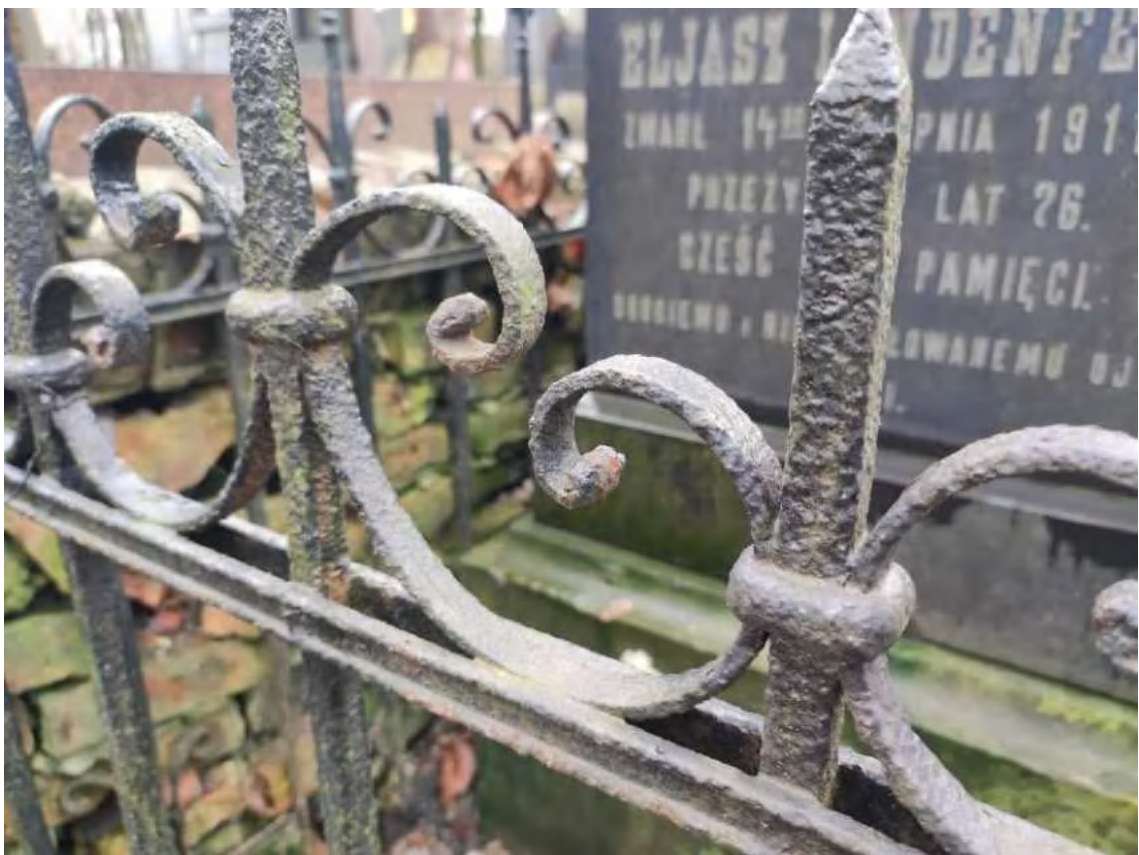
Stan zachowania ogrodzenia.
