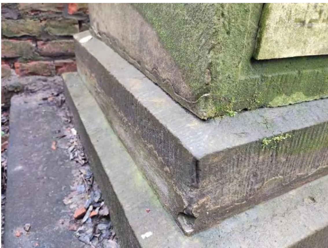
Nieestetyczne spoiny rozciągnięte na kamienne powierzchni.
