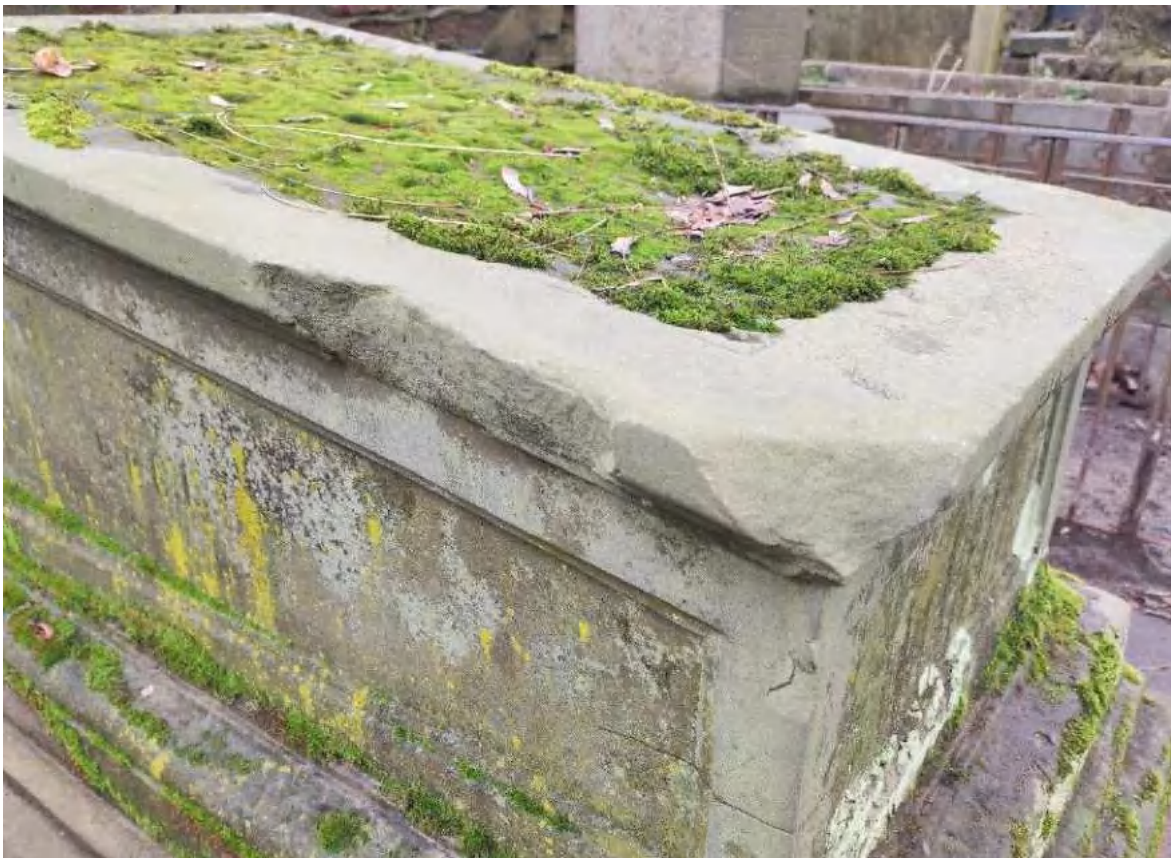
Ubytki wzdłuż krawędzi, nawarstwienia chemiczne i biologiczne.
