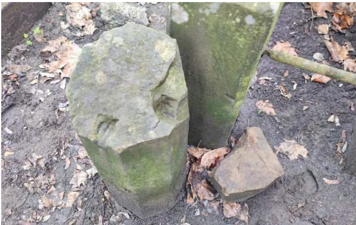
Słupek ogrodzenia z ubytkiem górnej części, ślady mocowania prętów ogrodzenia.
